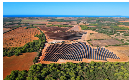
Impianto fotovoltaico Isole Baleari – Binatria
