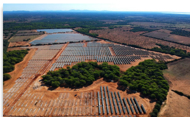
Impianto fotovoltaico Isole Baleari – Sa Caseta (2020)
