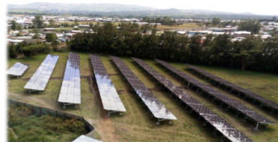
Impianto fotovoltaico e Storage a Wolisso, Etiopia
