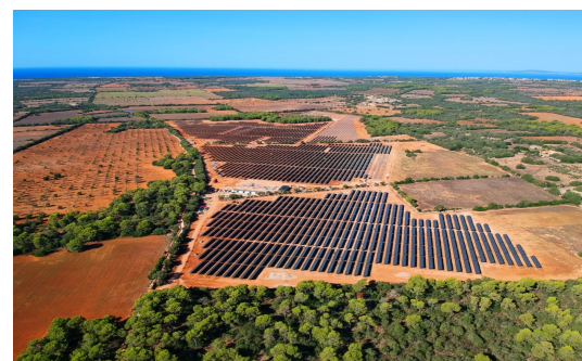
Impianto fotovoltaico Isole Baleari – Binatria
